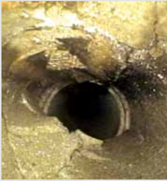
Eingebrochene Leitung Das Abwasser läuft in den Untergrund, ins Grundwasser.
