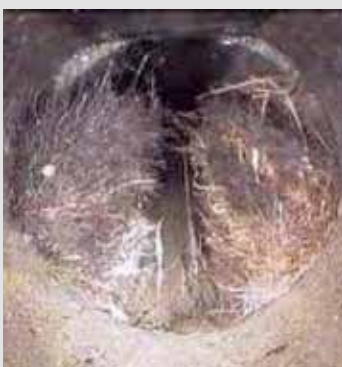
Wurzeleinwuchs Das Abwasser wird nicht mehr abfliessen.
